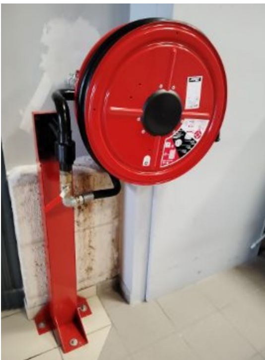
Salle des fêtes : ROBINET INCENDIE
